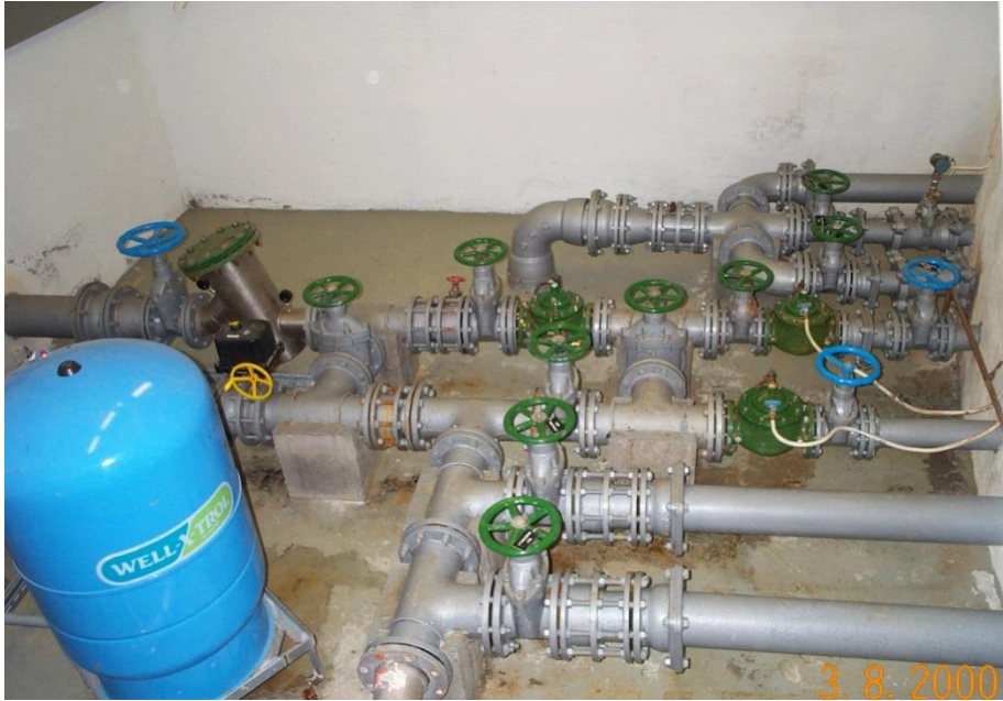
Ventilkammer Andslimoen høydebasseng
