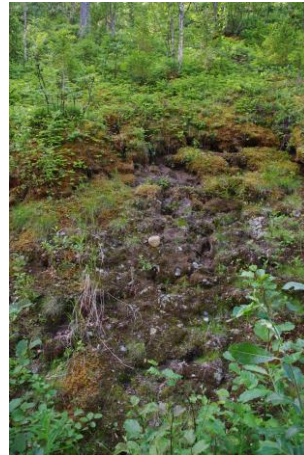
Skade langs vegggrøft
