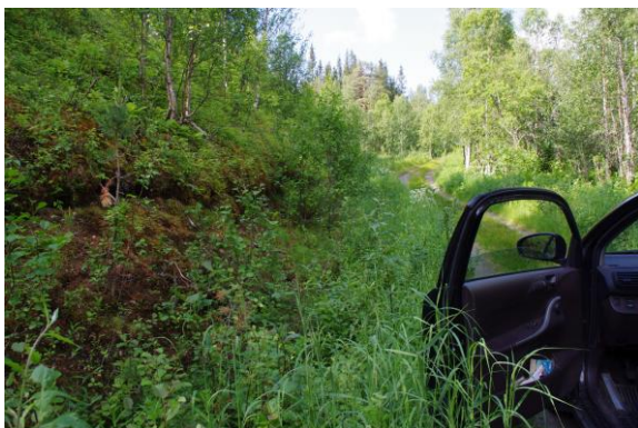
Skade langs vegggrøft
