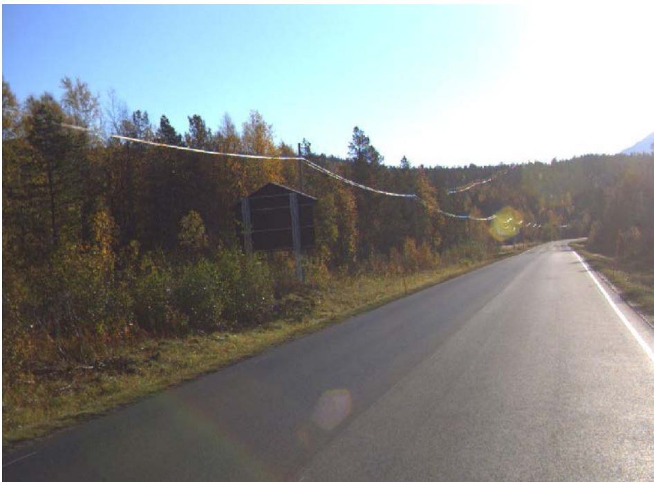
Figur 5 Bildet viser noe av kabeletatenes infrastruktur forlagt langs vegskulder.
